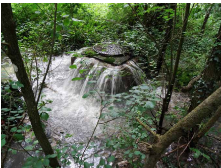
Débordement de la conduite de Valenton dans le bois des Berchères
